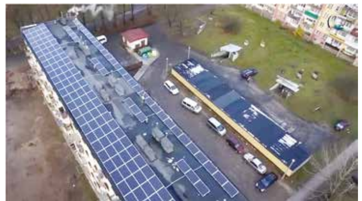
Rys. 8. Instalacja prosumenta lokatorskiego o mocy 127 kW w spółdzielni mieszkaniowej w Szczycynie
