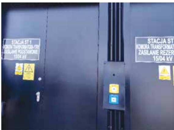
Drzwi stacji transformatorowej
